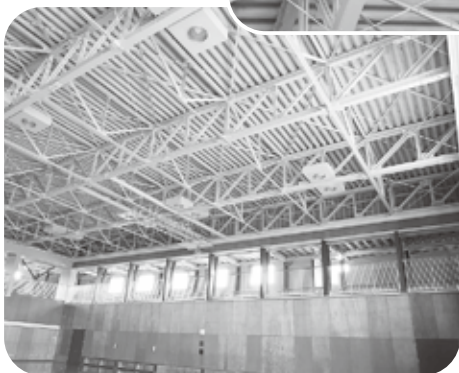
町民体育館の照明（水銀灯）
