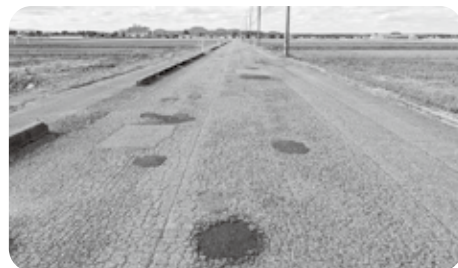
劣化の進む町道
