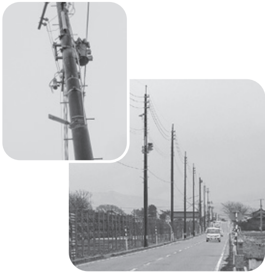
LED化した防犯灯
