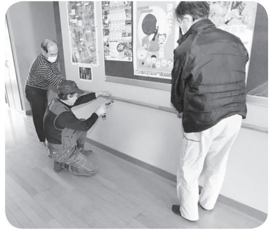
公民館整備事業の拡充が望まれる (支援が求められる軽微な改修 成田新田コミセン)
